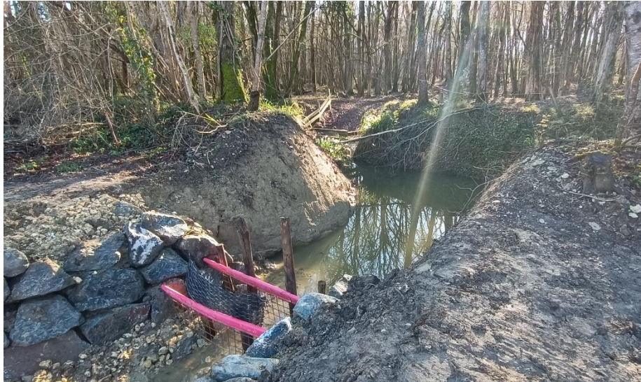
2 ème filtre en aval du 1 er filtre
