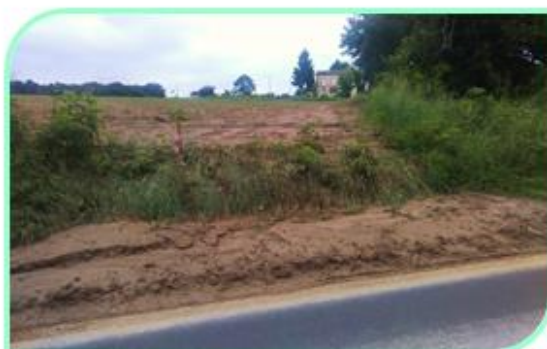
Dépôt boueux sur fossé et voirie
